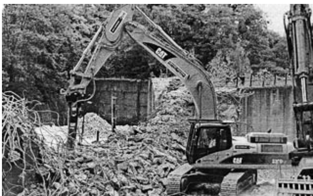
Ein CAT 330D Long Demolition aus der Mietflotte von MVS Zeppelin bei Rückbauarbeiten an Europas größtem Schiffsfahrstuhl Foto: MVS Zeppelin
